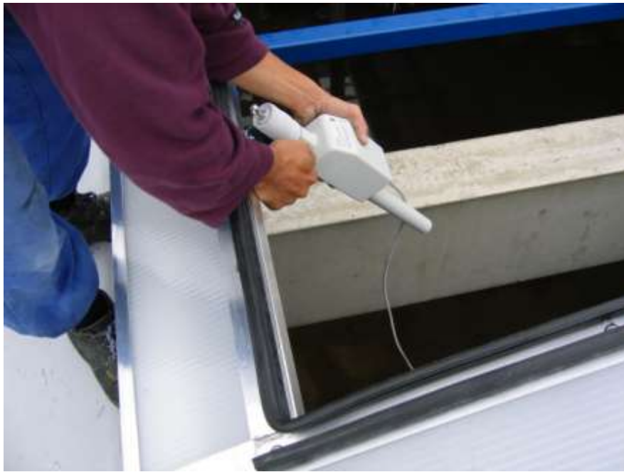
Abb.21 Die Motormontage ( Motor für Tagesentlüftung )
